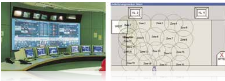
Abbildung 7. Kontrollraum für die Müllhaldenüberwachung und Screenshot des Layouts für die Zonenüberwachung, bei der eine FLIR Infrarotkamera auf einem ferngesteuertem Schwenk/Neigekopf als Brandmelder eingesetzt wird.
